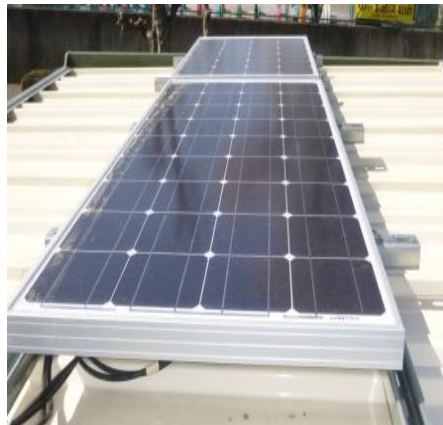
4号機太陽光パネル部
